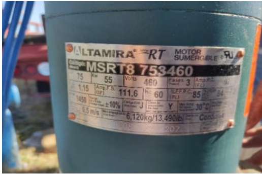
bomba de 75 HP marca altamira
