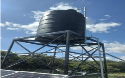
cisterna de 10,000 litros y base metalica de ptr a medida
