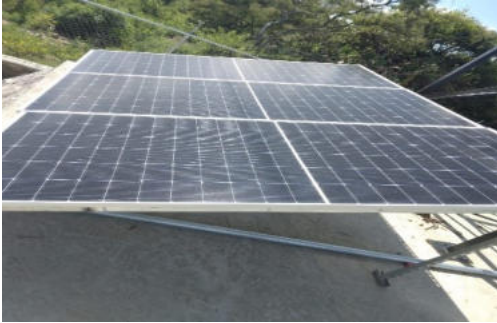
paneles solares con base metalica
